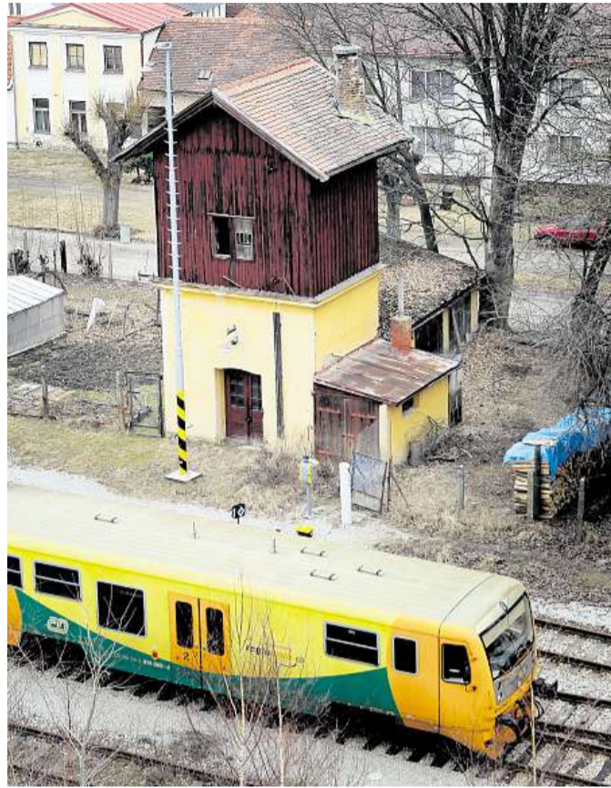
Historická stavba Vodárenská věž je už řadu desetiletí zamčená. Její horní dřevěná část nebyla natřena 50 let. Foto: Ladislav Němec, MF DNES
