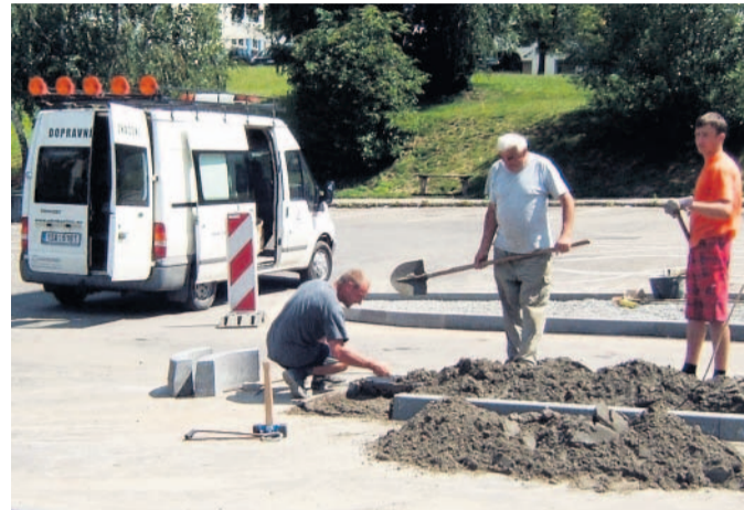
Automat Na benešovském parkovišti Pod Brankou dělníci připravují vjezd se samoobslužnou pokladnou a závorou. Foto: M. Zikmundová, MF DNES
