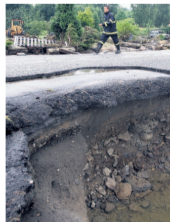
Tady byla silnice Zničené jsou také silnice, oprava potrvá hodně dlouho.
