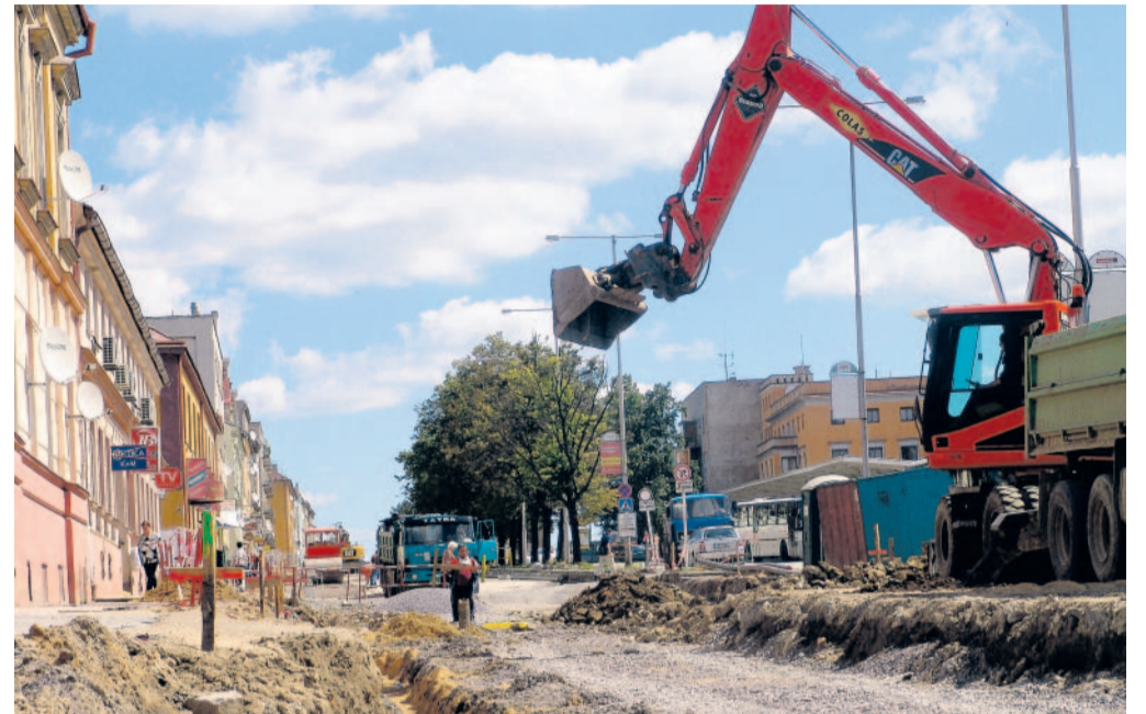
Dříve autobusy, teď tudy jezdí bagry Rozkopaná ulice Milady Horákové ve Znojmě těsně sousedí s budoucím autobusovým terminálem, který postaví až v září.
