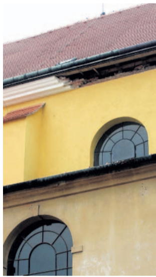
Několikátunová část římsy z kostela sv. Františka Xaverského v Hradišti spadla před třemi týdny. Foto: MF DNES
